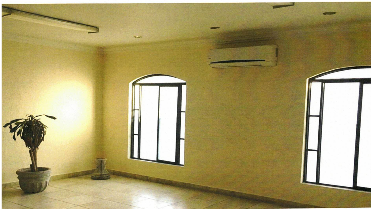
IMAGEN 10.- DESPACHO 3 (PRINCIPAL) OFICINA COLINDANTE CON LA SALA DE JUNTAS, EL CUAL SE ENCUENTRA DEBIDAMENTE PINTADA, CON TECHADO ÚTIL Y EN BUEN ESTADO, CON VENTADAS DE HERRERÍA Y LOS CRISTALES COMPLETOS Y EN BUEN USO. LOS AZULEJOS CON SU DESGASTE NATURAL Y ALGUNOS MUESTRAN FRACTURAS, Y LOS ENCENDEDORES, LUMINARIAS Y CONTACTOS DE LUZ Y TELÉFONO, ÚTILES Y SERVIBLES, CUENTA CON AIRE ACONDICIONADO CON SU CONTROL, ASÍ MISMO CUENTA CON UNA MACETA DE CANTERA TAL Y COMO SE APRECIA EN LA IMAGEN FOTOGRÁFICA.
