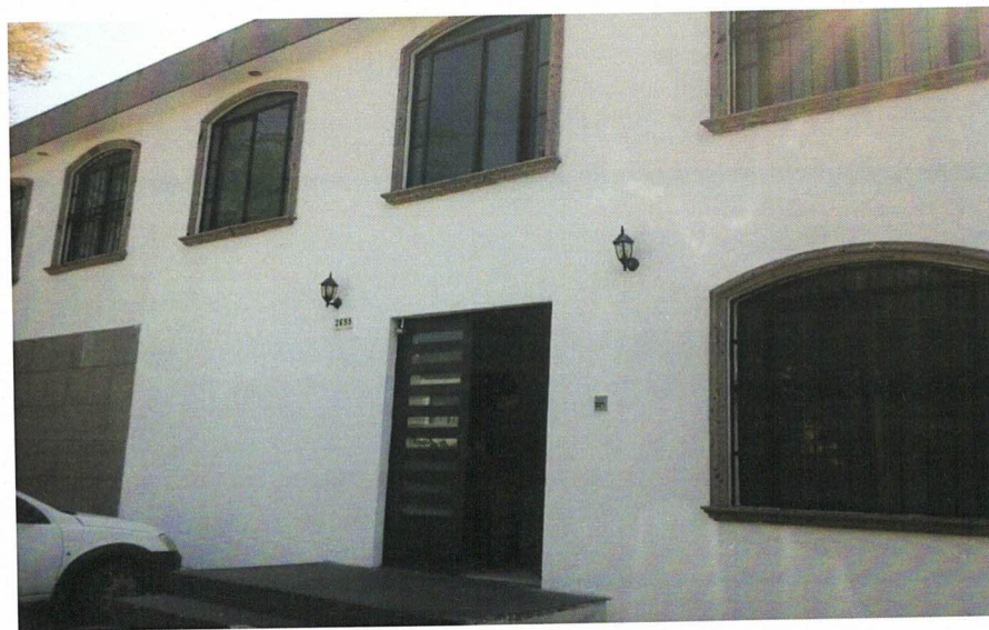
IMAGEN 1.-FACHADA DEL INMUEBLE POR CALLE LA LUNA. PINTADA EN BLANCO, CON EL TRABAJO DE CANTERA EN BUEN ESTADO. CON LAS LUMINARIAS Y LA PUERTA DE INGRESO DEBIDAMENTE PINTADA EN NEGRO, DE HIERRO Y CON LOS CRISTALES EN COLOR TURQUESA EN BUEN ESTADO, ESCALERAS LIMPIAS CON EL DESGASTE PROPIO QUE A SU USO AMERITA, VENTANALES Y HERRERÍA EN BUEN ESTADO.
