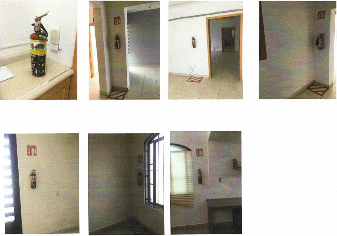
IMAGEN 28.- EXTINTORES: EL INMUEBLE CUENTA CON 7 EXTINTORES 1 DE RESPUESTO (NO SE APRECIA EN IMÁGENES), MODELO CO2 5 LBS DE 2.5 KGS, POR LO QUE LA ARRENDATARIA DEBERÁ DARLE SU MANTENIMIENTO PERIÓDICO.
